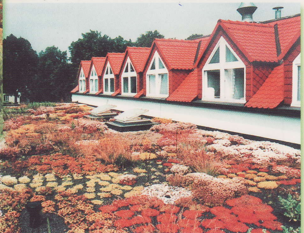
Dachbegrünung - extensiv mit ulopor ® Blähschiefer
